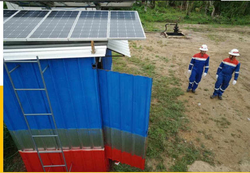
Instalasi GEMPI house di PEP Tarakan Field
