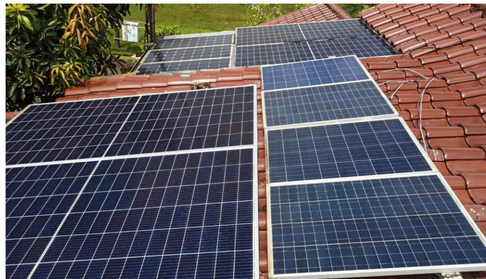
Penggunaan panel surya di rumah Gusman Chaniago.
